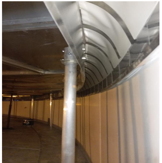
پرده آبنبد و گازبند از جنس پی تی اف ای و سیستم کفشک و فنر مکانیکی سقف شناور داخلی
